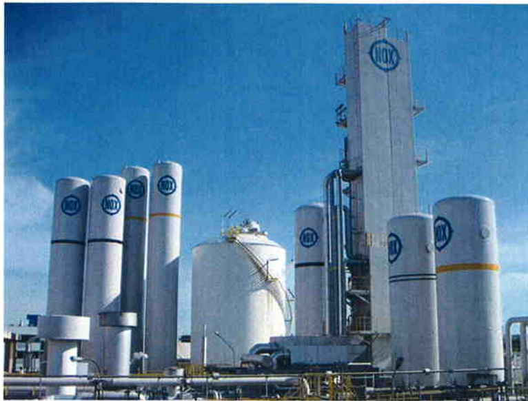
NOX 3号プラント全景
