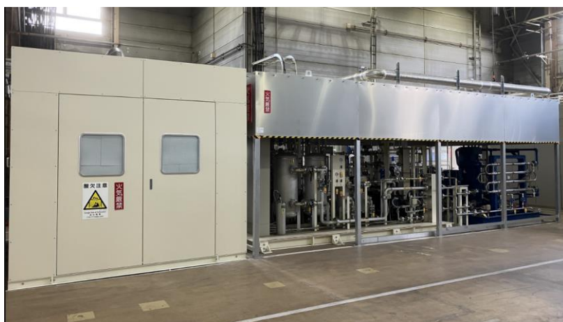
アンモニアから FCV 用燃料品質を満たす水素製造を実証した試験装置外観
