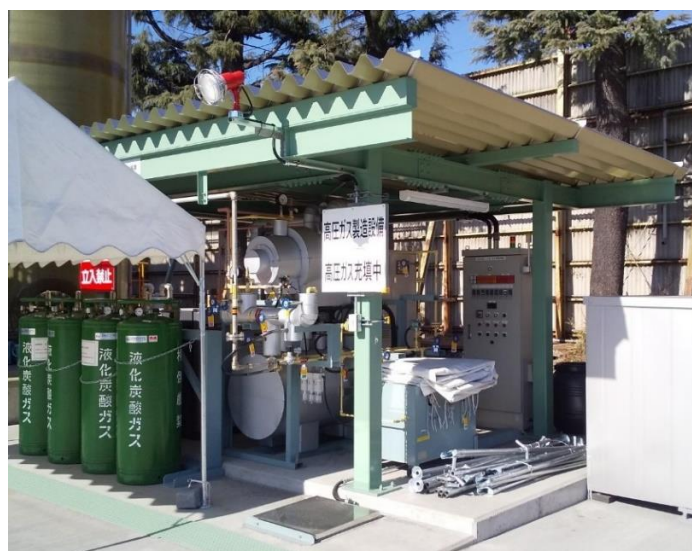
CO 2 液化設備外観
