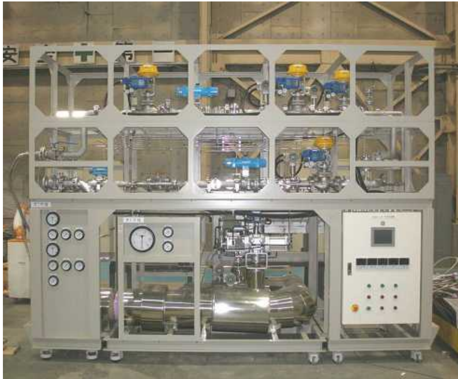
バーナ制御システム外観
