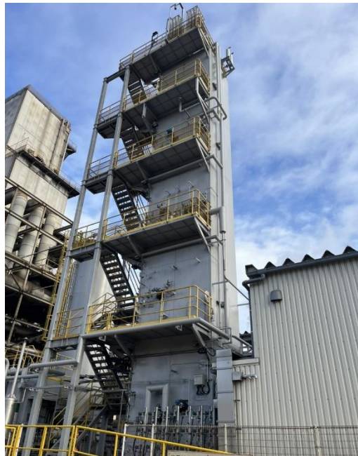
完成したレアガス製造装置
