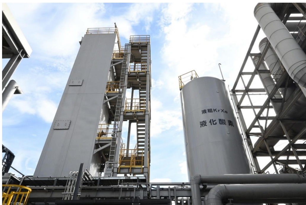
新たに設置したレアガス製造装置
