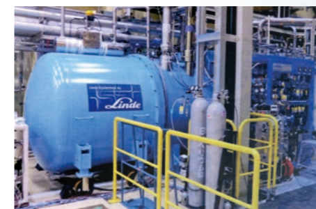
ヘリウム冷凍システム (TCF200) 冷凍能力: 6,000W below 20.6K
