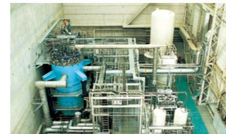
ヘリウム冷凍機 冷凍能力: 5.65kW (4.5K) 20.6kW (80K) 650L/H
